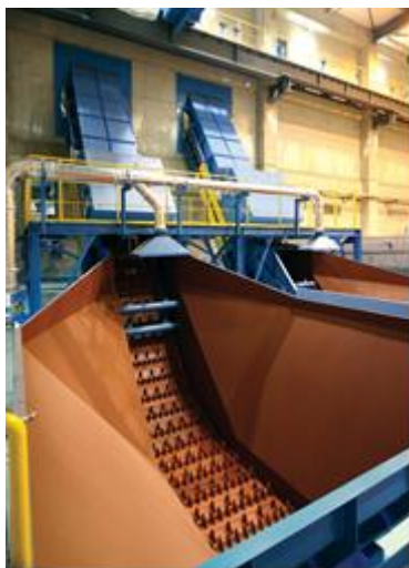
受入供給コンベヤ
